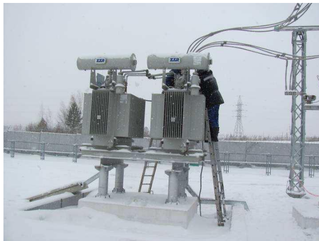
Рисунок 5 – Преобразовательный блок на подстанции
